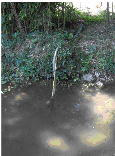
Figure 18 : POMPAGE D'EAU D'UN PARTICULIER SUR LE MAGOT AU NIVEAU DE TOUCHEBURE
